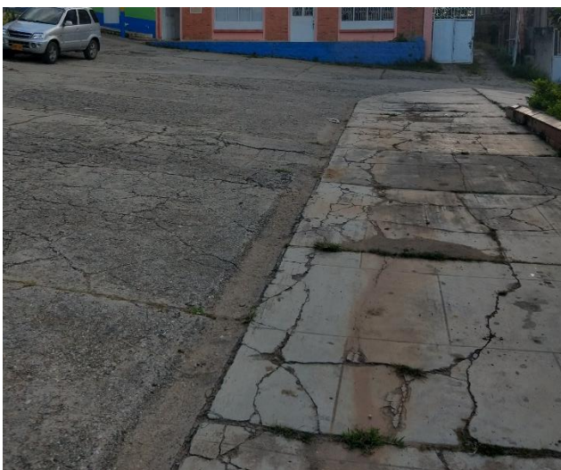
Figura 27. Estado de las calles Chaguaní. Autoría propia (2019).
