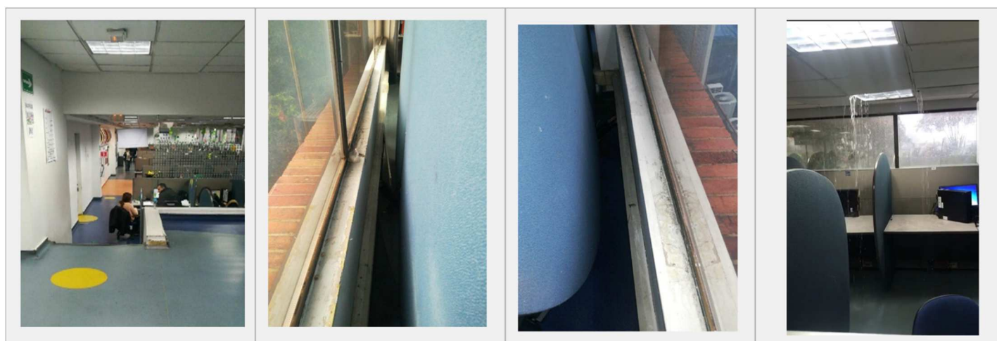
Figura 24. Estructura en mal estado.
