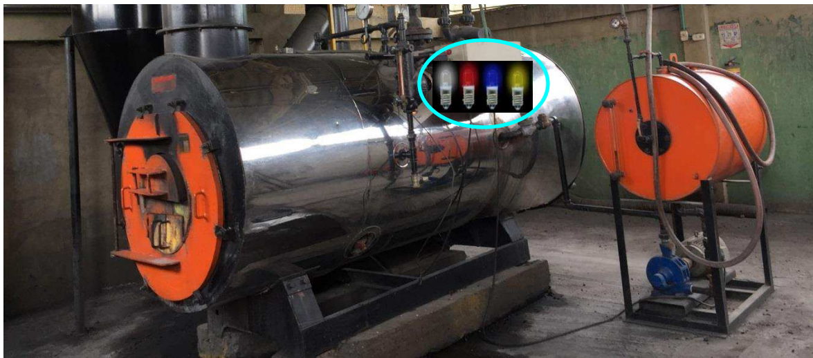
Figura 25. Fotografía caldera con montaje de método ANDON. Nota: Autoría propia
