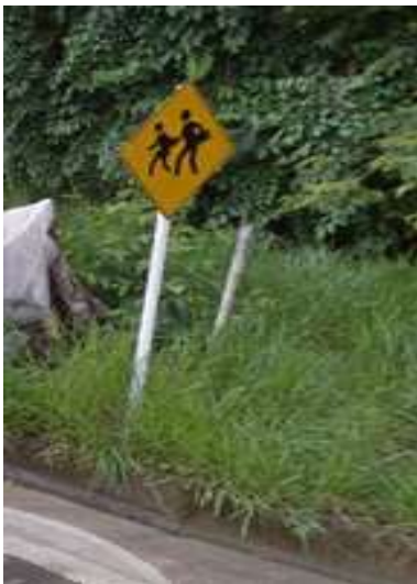
Figura 25. Señalización vial- el Morro. Google Maps (2020).
