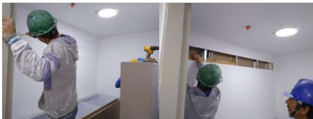
Figura 7. Reproceso por instalación de refuerzo. Fuente propia (2020).
