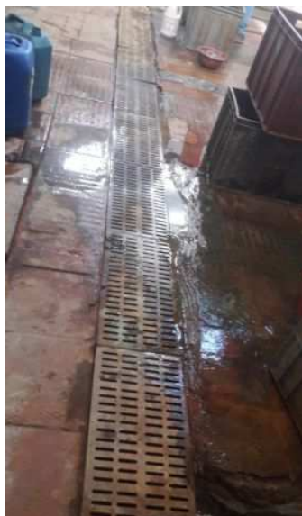
Figura 43. Rejillas de alcantarillado líneas de cromado y pre-lectrolítica.
