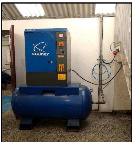
Figura 64. Compresor industrial. Nota: Autoría propia.
