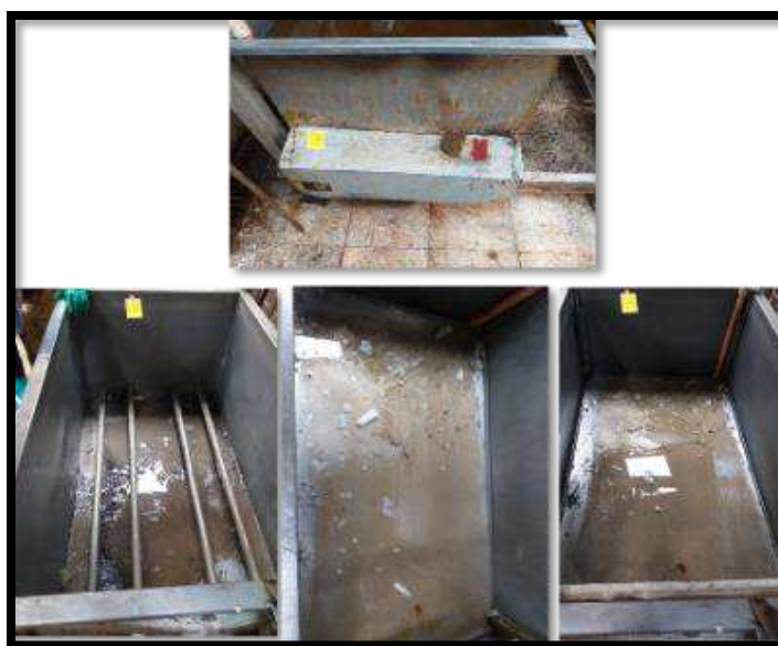
Figura 73 Línea domestica calibre 18, tanque de inmersión.
