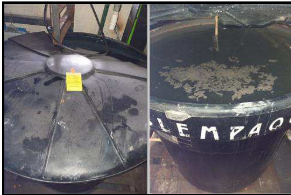
Figura 66 Tanque de almacenamiento mezcla coagulante.
