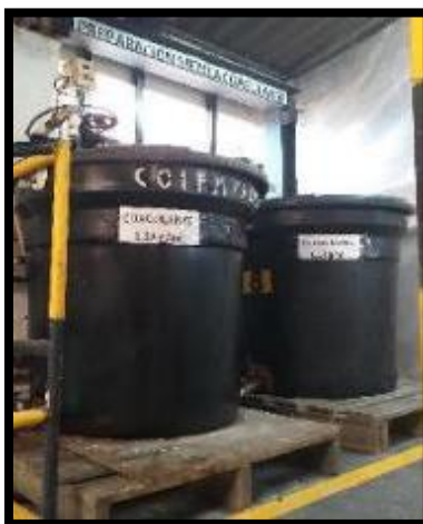
Figura 77 Área de mezclas- preparación mezcla coagulante, delimitación de espacios de trabajo y demarcación de elementos del área.
