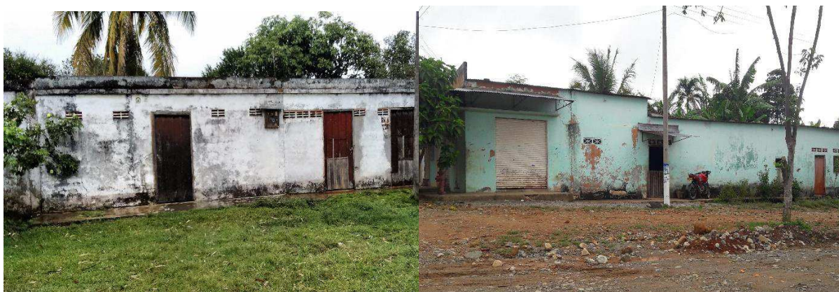
Figura 10. (Fotografías propias. Viviendas en estado de deterioro)
