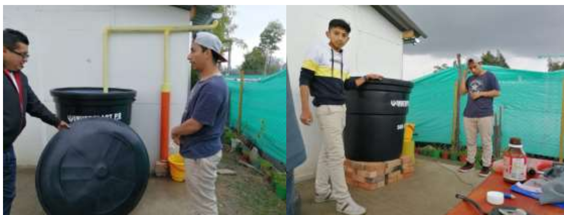
Figura 40 Documentación de instalación del sistema de captación y almacenamiento de agua lluvias. Elaboración propia
