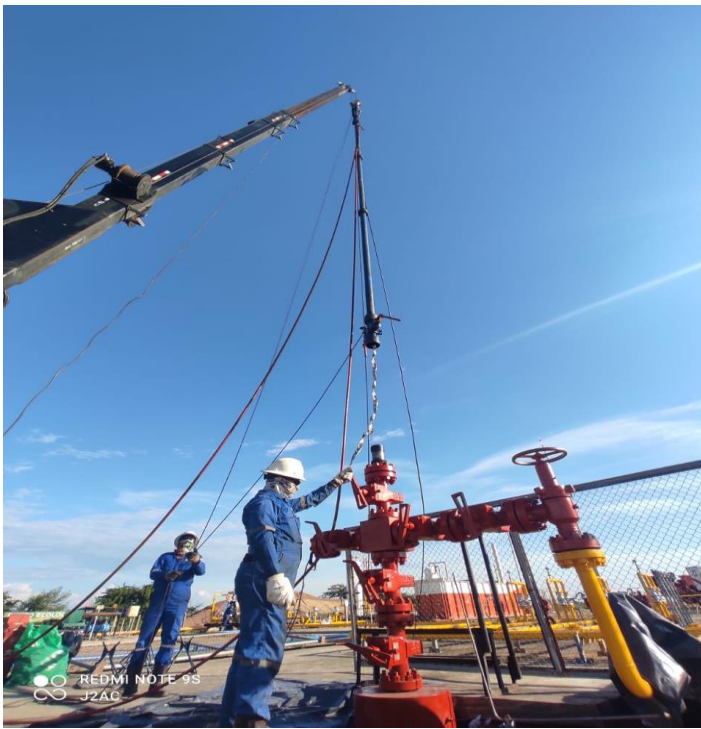
Figura 12. Armado de herramienta para la realización del trabajo, Pozo Revancha 8. Tolima, (diciembre 2020)
