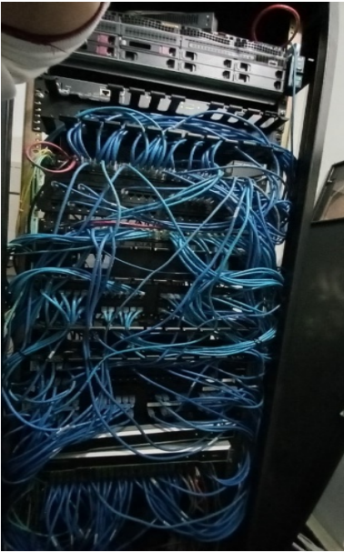
Figura 33. Trenzado del Rack 2 Bodega de carga. Fuente propia.
