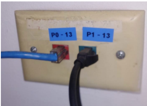
Figura 28. Punto de Red 11 Ubicado en Financiera-Comercial segundo piso. Fuente propia.
