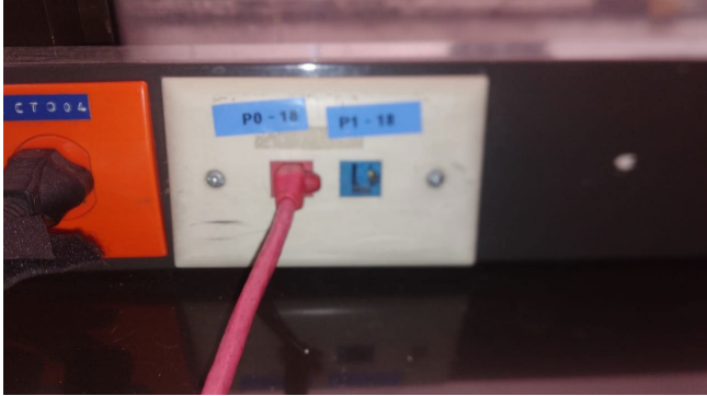
Figura 27. Punto de Red 10 Ubicado en Financiera-Comercial segundo piso. Fuente propia.
