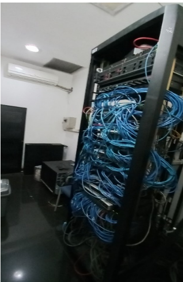
Figura 32. Trenzado del Rack 2 Bodega de carga. Fuente propia.
