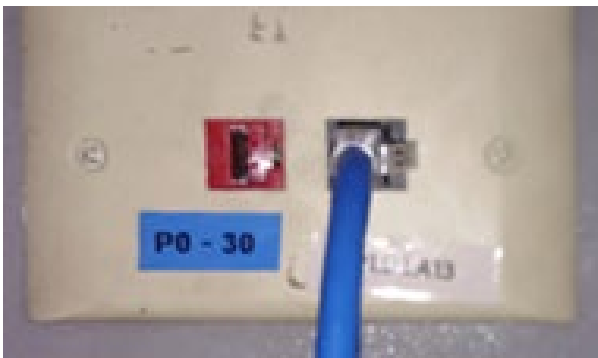
Figura 18. Punto de Red 5 Ubicado en Call Center primer piso. Fuente propia.
