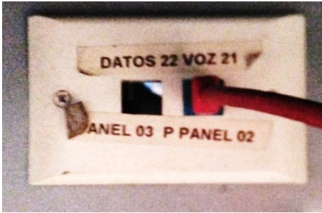
Figura 14. Punto de Red 1 Ubicado en Call Center primer piso. Fuente propia.
