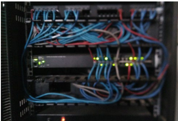
Figura 12. Rack 2 ubicado en Bodega de Carga primer piso. Fuente propia.
