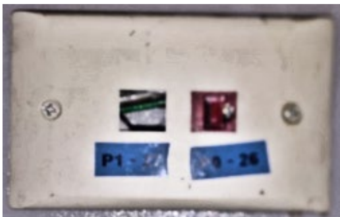
Figura 25. Punto de Red 8 Ubicado en Financiera-Comercial segundo piso. Fuente propia.
