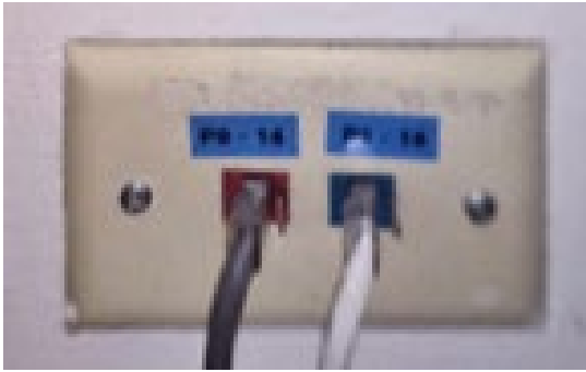
Figura 29. Punto de Red 12 Ubicado en Financiera-Comercial segundo piso. Fuente propia.
