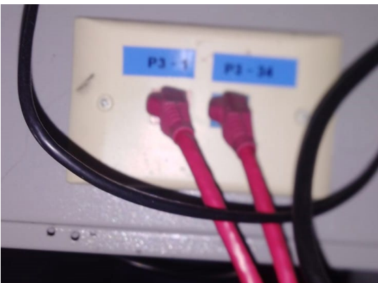
Figura 20. Punto de Red 2 Ubicado en Financiera-Comercial segundo piso. Fuente propia.
