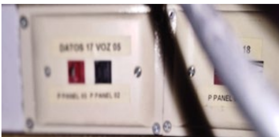
Figura 23. Punto de Red 5 y 6 Ubicado en Financiera-Comercial segundo piso. Fuente propia.
