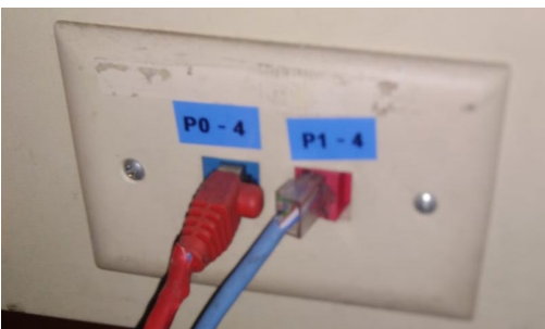
Figura 21. Punto de Red 3 Ubicado en Financiera-Comercial segundo piso. Fuente propia.
