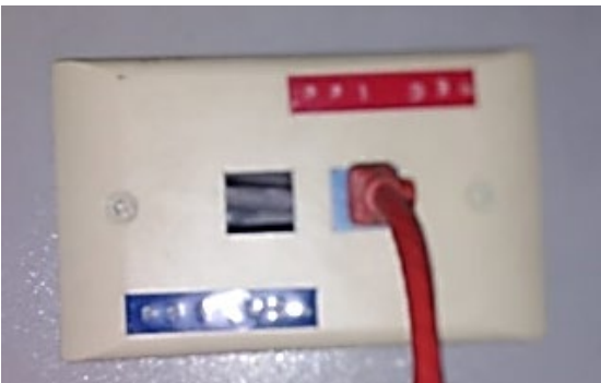
Figura 16. Punto de Red 3 Ubicado en Call Center primer piso. Fuente propia.
