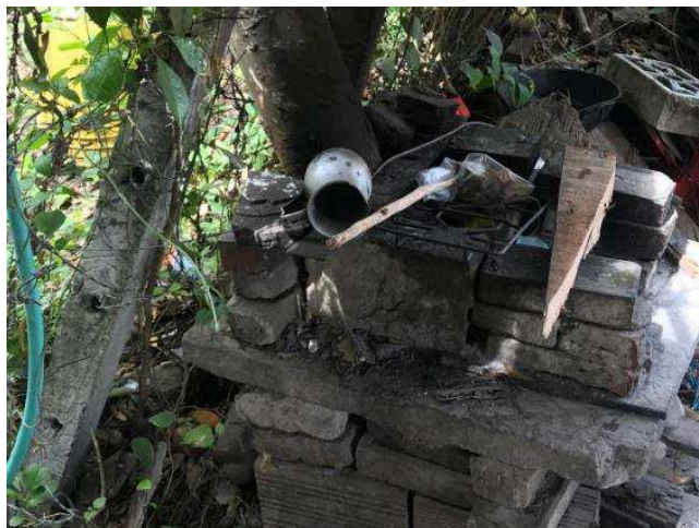
Figura 49. Estado actual de la zona de servicios, hacinamiento, fuente propia.
