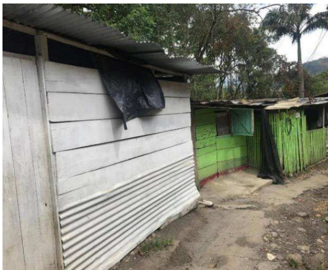
Figura 50. Falencias en el sistema constructivos, fuente propia.
