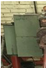
Entrada y salida de agua para refrigerar molino
