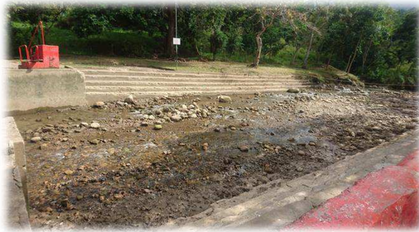
Figura 22 Estado Piscina Municipal de Guaduas. Fuente propia.
