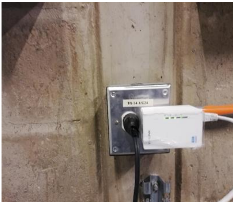
Figura 41 Conexión a circuito 24
