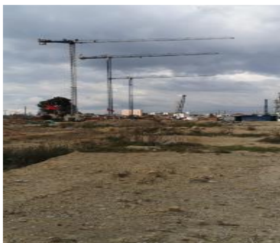
Figura 6. Proyectos realizados por la empresa Instaelectricos RMS S.A.S (2021).
