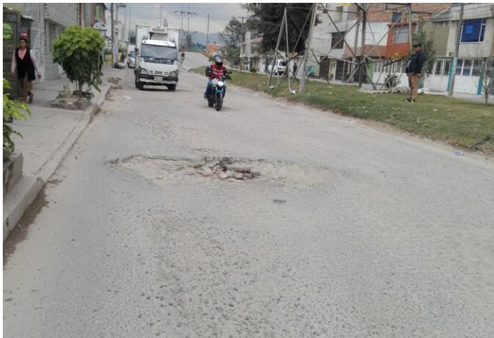
Figura 1. Calles deterioradas en Bosa. Latorre (2018).
