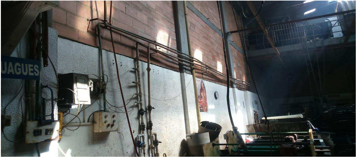
Figura 7. Señalización de las instalaciones. Nota: Autoría propia
